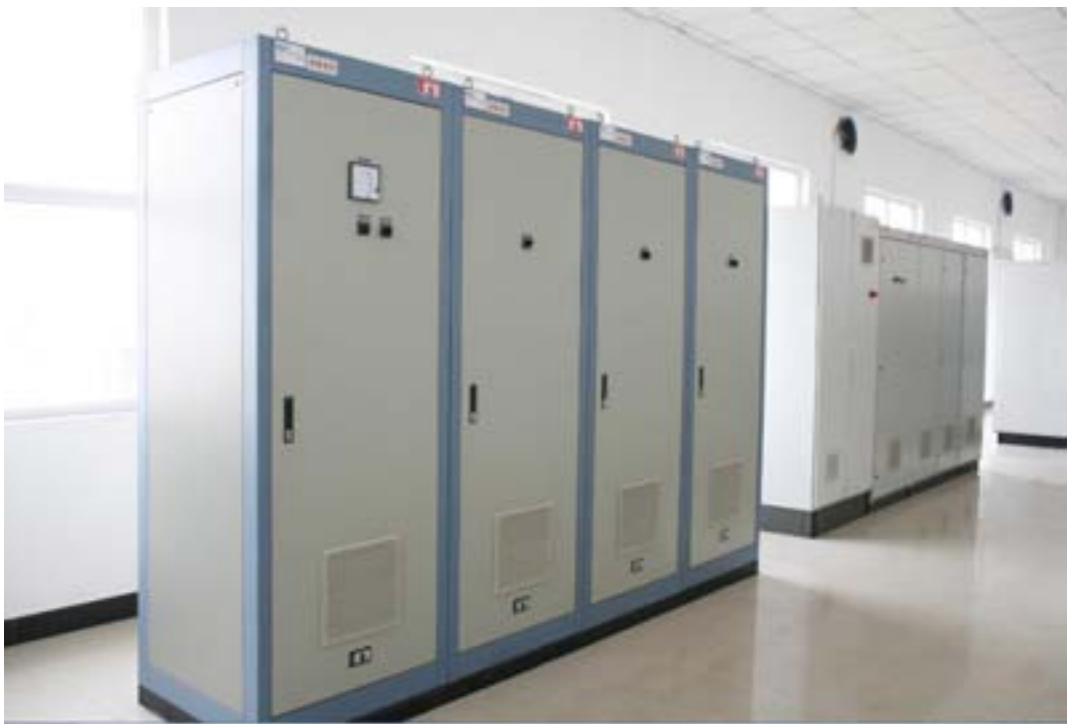
图 5-5 PLC 及接口控制柜
