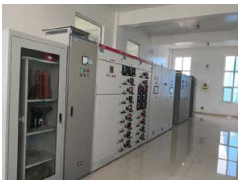
图 2-9 低压配电+磁场（含灭磁）控制+PLC 控制室
