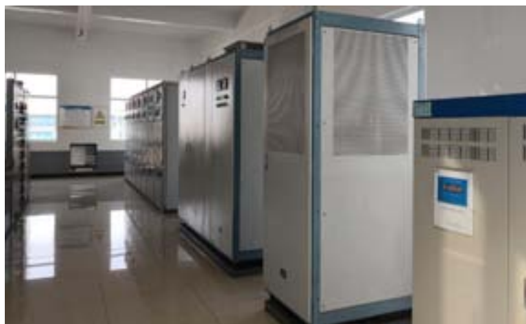
图 1-5 高、低压配电+磁场（含灭磁）控制+PLC 控制室
