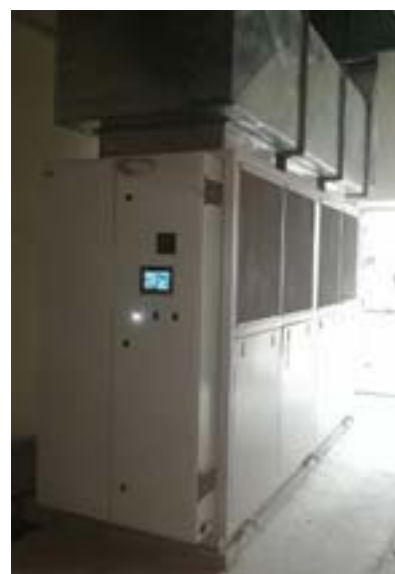
图 8-6 变频器外水冷机组
