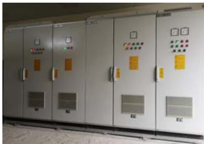
图 8-3 副井提升直流控制系统
