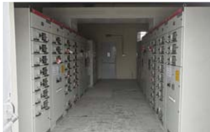
图 8-8 MNS 低压配电柜
