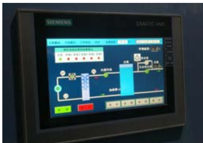
图 2-5 变频器内水冷监控画面
