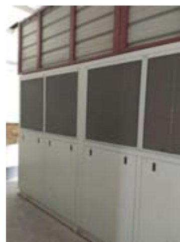
图 7-5 变频器外水冷机组
