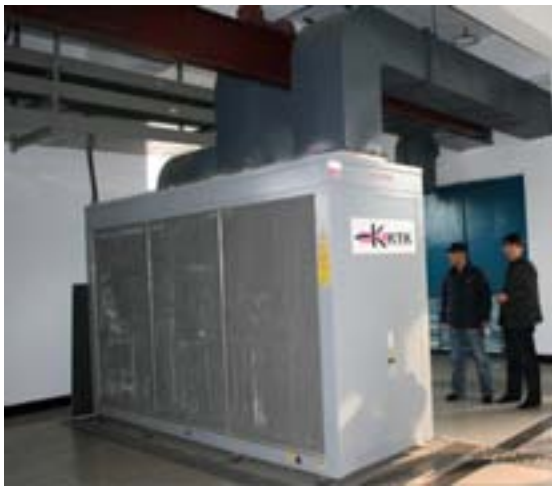
图 5-3 变频器外水冷机组
