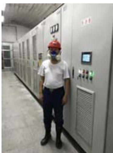
图 3-1 高压变频器（硐室安装）
