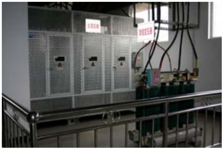
图 5-4 主整流变压器+磁场整流变压器
