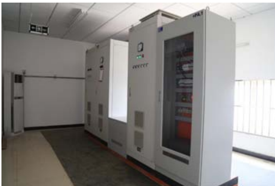
图 6-2 PLC 及低压电源控制柜
