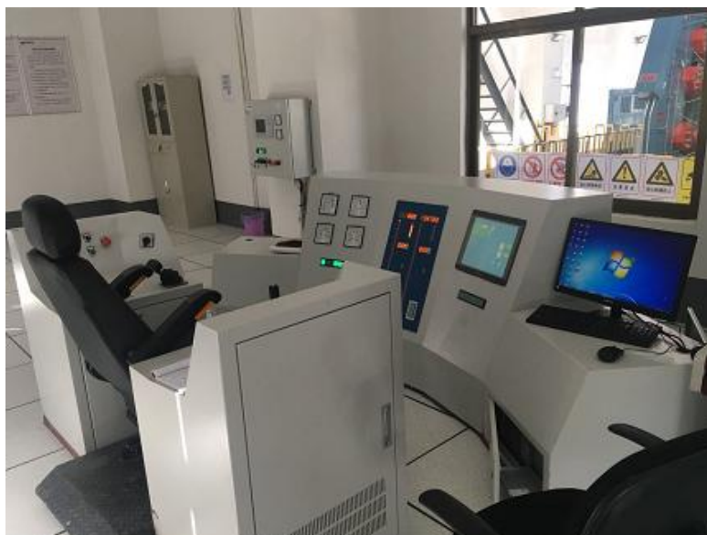
图 7-2 CZT409 扇形操作台+上位监控
